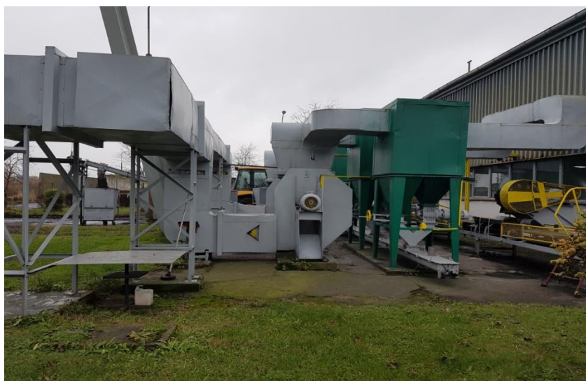
Rys.1. Widok instalacji odpylania kotła nr 2.
